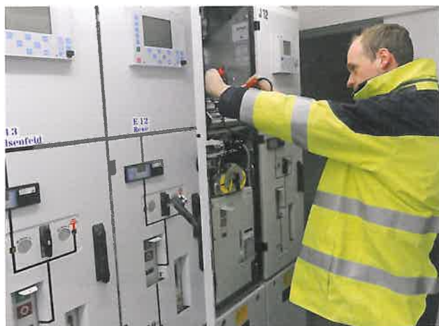
Obwohl die neue Schaltanlage weitgehend automatisiert ist, muss immer einmal wieder ein Experte des EZV vorbeischauen und nach dem Rechten sehen.
