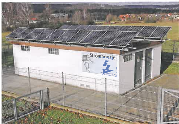
Im Stromhäusje – genauer in der Trafostation E19 – nahm der EZV Ende 2013 eine neue 20-kV-Schaltanlage in Betrieb.
