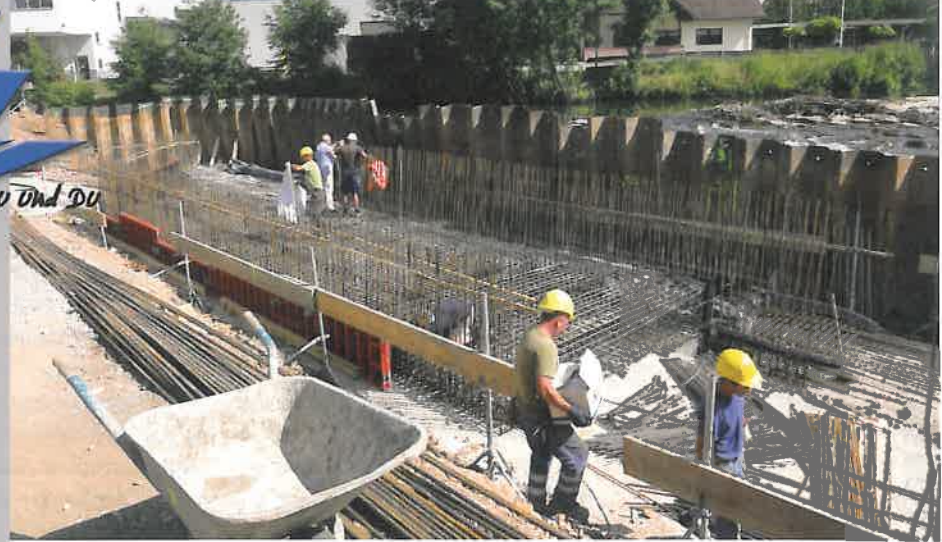
Die Bauarbeiten für das Wasserkraftwerk an der Mömling starteten im Mai. Anfang Juni war das Fundament fertig.
