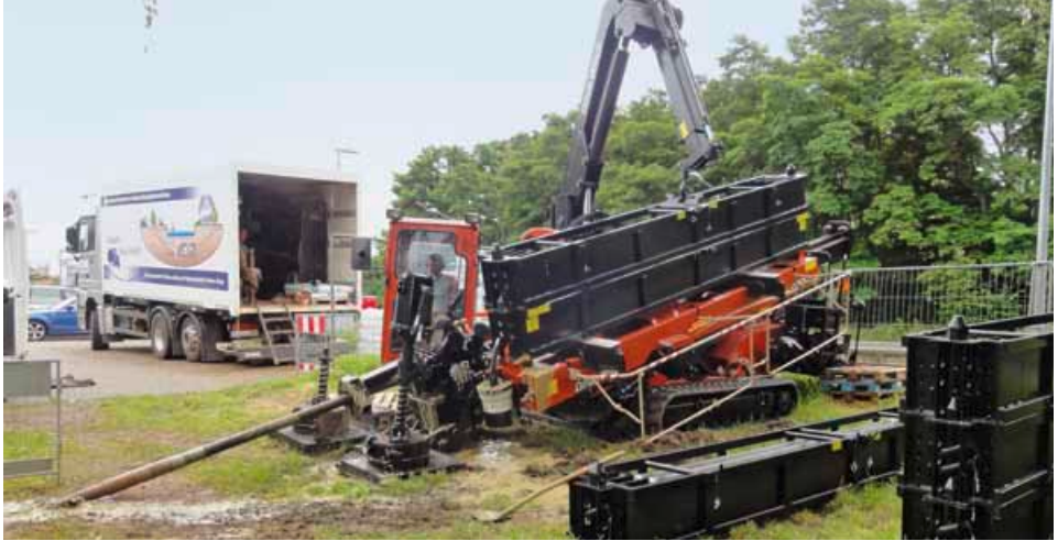
Zentimeter für Zentimeter frisst sich der Bohrer unter dem Main hindurch. Nach jeweils ungefähr drei Metern verlängert der Maschinenführer das Bohrgestänge um ein weiteres Segment. Auf diese Weise kann das leistungsfähige Gerät bis zu 800 Meter weit bohren.
